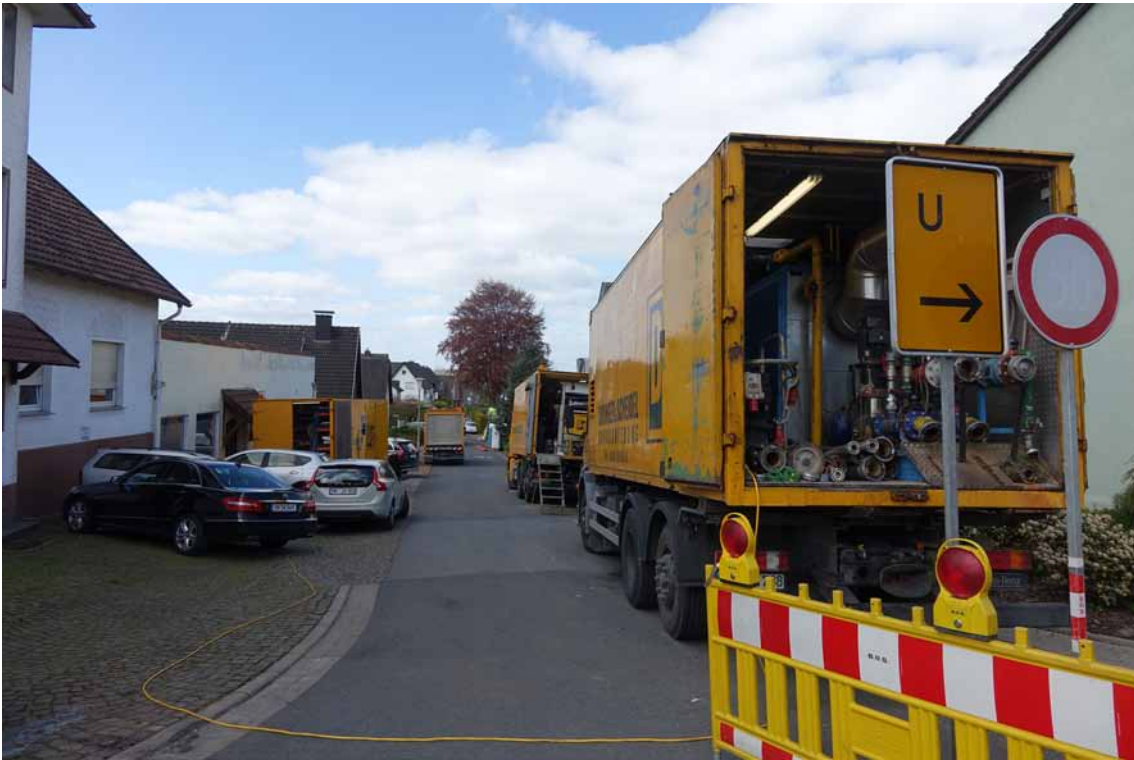
Grabenlose Kanalsanierungsmaßnahme in Hiddenhausen: Neben einem Materialwagen, dem Sozialwagen und den Fahrzeugen mit der Heizungsanlage gehört ein Inversionsturm zur Baustelleneinrichtung.
