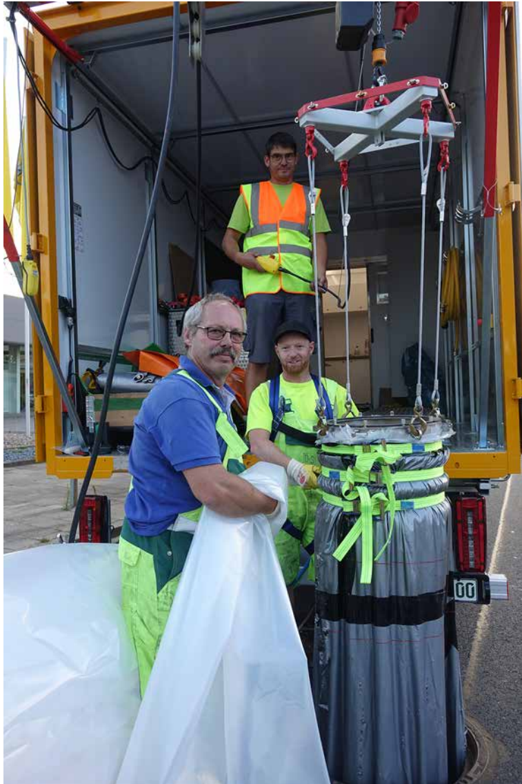
Hinrich Freese (l.) und Anlagenführer Tino Schubert von D&S Rohrsanierung, NL Oldenburg, bereiten zusammen mit Heribert Schedlbauer, Projektleiter bei Vertiliner, die Anlage für den Einsatz vor.
